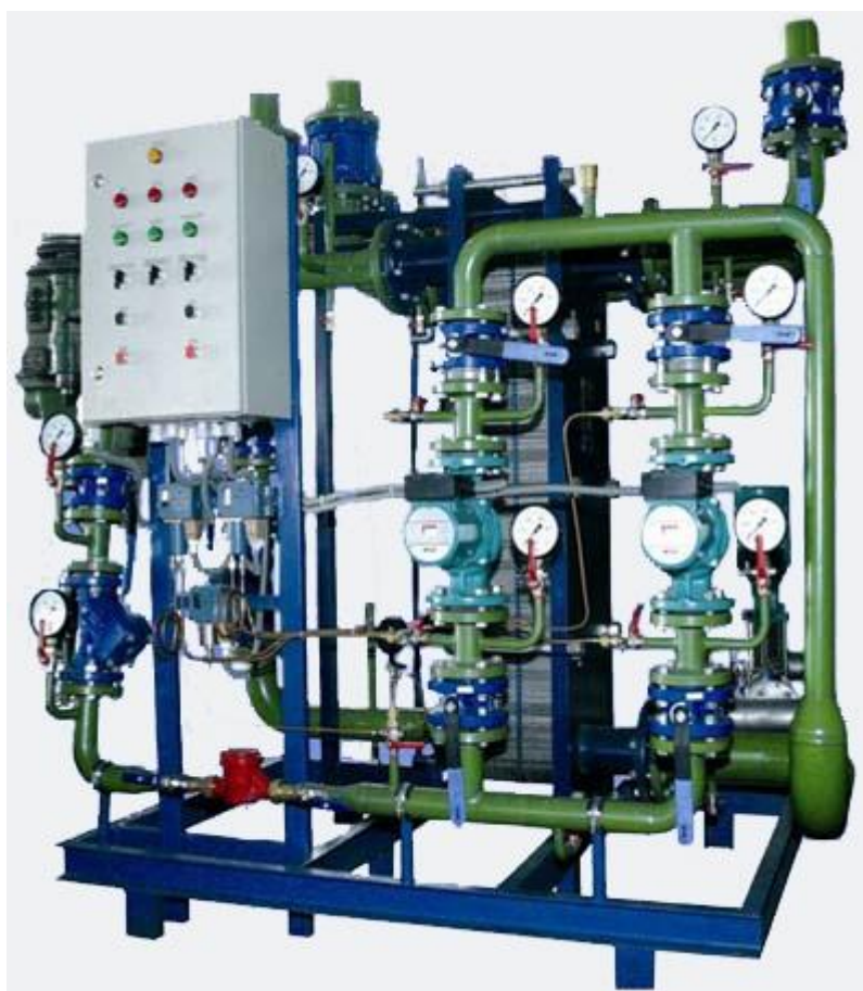
Рисунок 18 - Автоматизированный тепловой пункт
